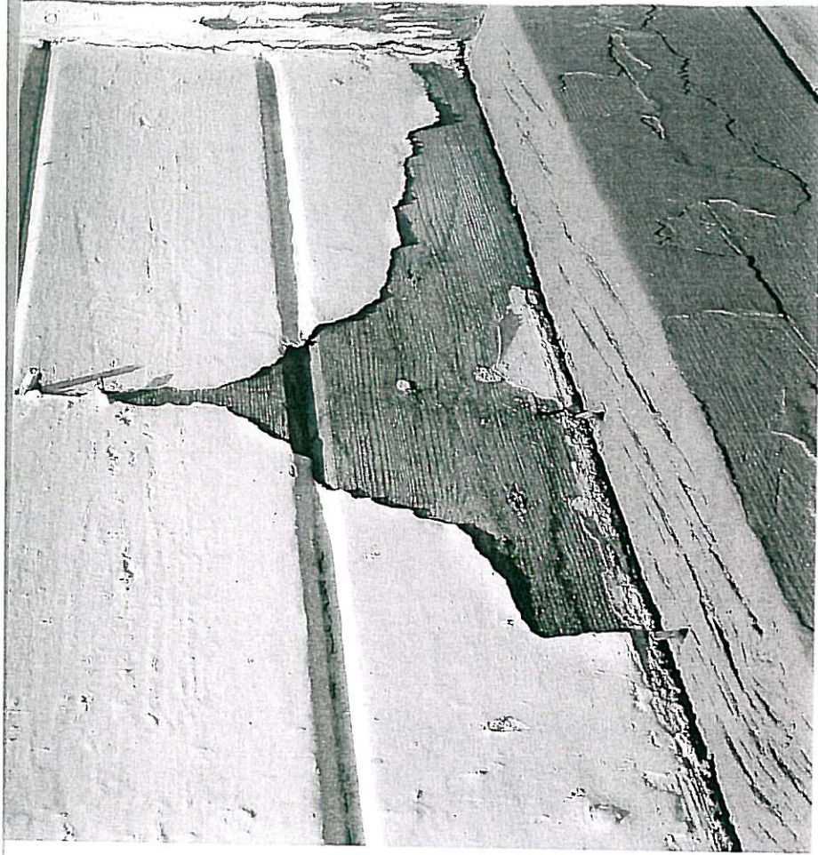
En modern alkydoljefärg som flagor. Alkydoljefärgen ger en relativt stark film som dock flagar i större partier. Färgbortfallet ger i regel vassa och höga kanter och upptäts påtagligt även sett från håll.
